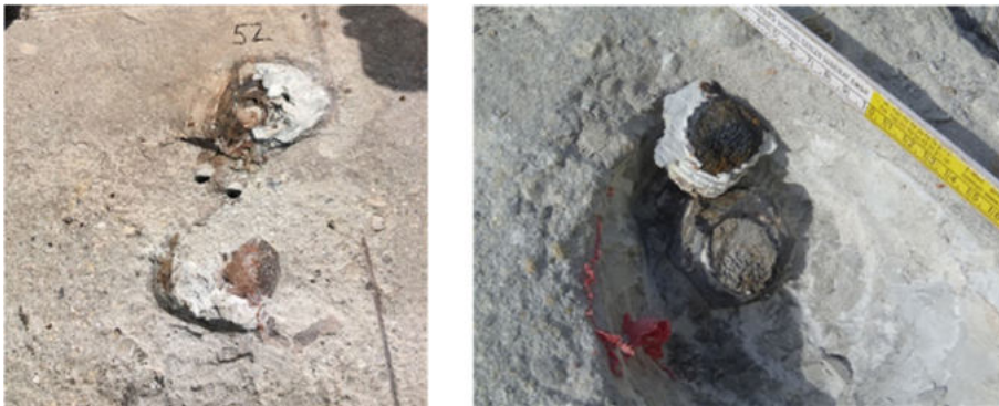
Abb. Korrosionsschäden an oberliegenden Spanngliedern
