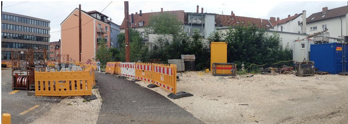
Nordrand des Plangebietes: keine Gehölzstrukturen mehr am Nordrand Richtung Karlstraße (= Baustelle Straßenbahn); Richtung Osten (Blickrichtung) schmaler Rest-Gehölzstreifen (junge Birken, Berg-Ahorn, Salweide, Clematis, Efeu etc.); keine Vogel-nester oder Baumhöhlen
