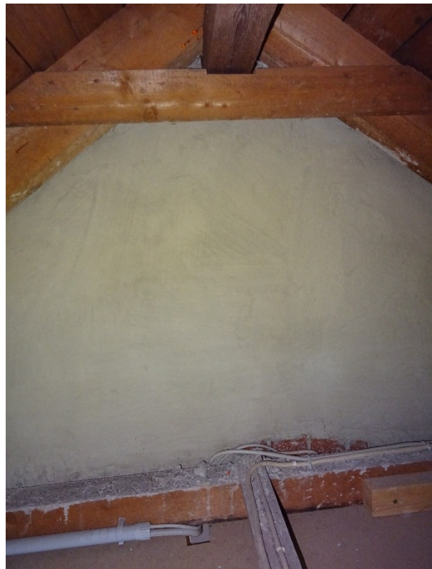
An den Giebeln waren neben Spinnweben (oben, auf dem Foto nicht erkennbar) nur Putz-Reste vorhanden.
