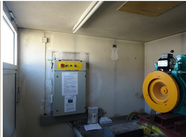
... mit benachbartem Technikraum.
