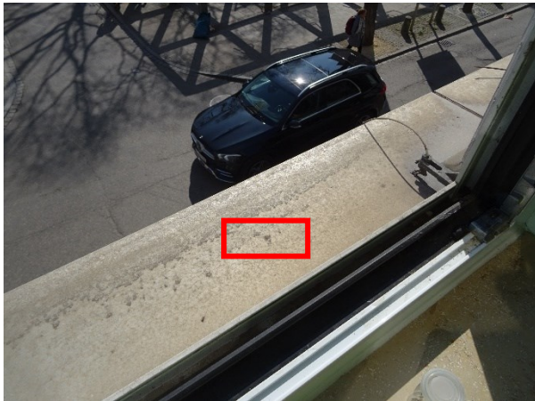
Hier wieder auf einer Fensterbank, ...
