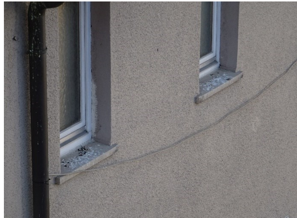
... und mit Kot (Tauben) auf einigen Fensterbrettern.
