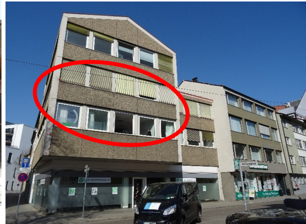
Ansicht von Osten (mit Fledermaus-Kot an/auf den Fenstern, s. Markierung – die Jalousien im 2. Stock wurden wohl erst kürzlich heruntergelassen) ...
