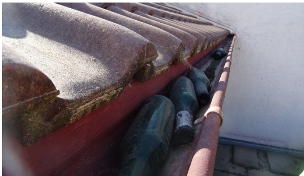
... und „Nutzungsspuren“ in der Dachrinne.
