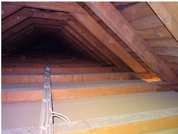
... der nicht mehr isoliert war, aber dennoch dicht ...
