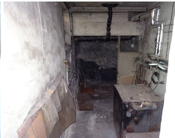
Auch die Kellerräume des anderen Haus-Teil ...
