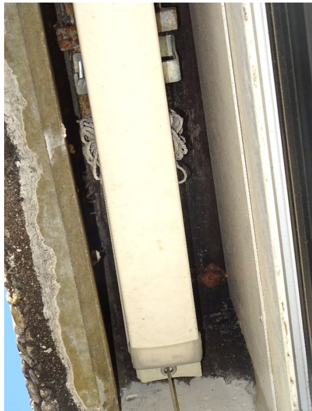
... sind hier ohne größeren Spalt an der Außenwand aufgehängt. In den relativ großen Aussparungen sind die Jalousien befestigt.
