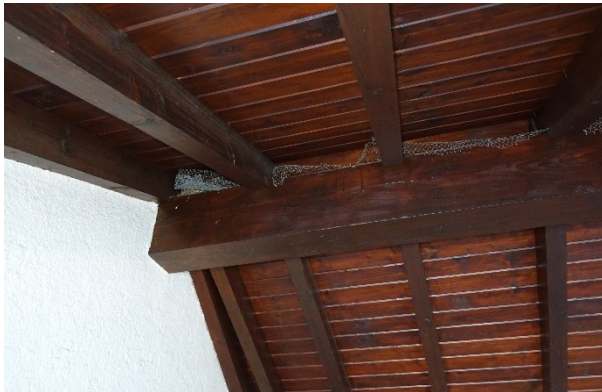
... Vogelnest (links am Rand, trotz Vergitterungs-Versuch) im Dachgebälk ...
