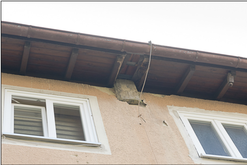
Abb. 9: Mutmaßliches Brandschutzelement mit Spaltenangebot (21.04.2021)
