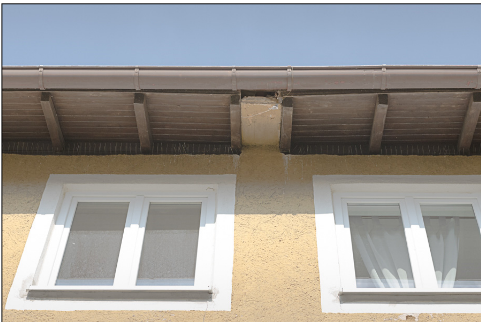
Abb. 8: Mutmaßliches Brandschutzelement mit Spaltenangebot (21.04.2021)
