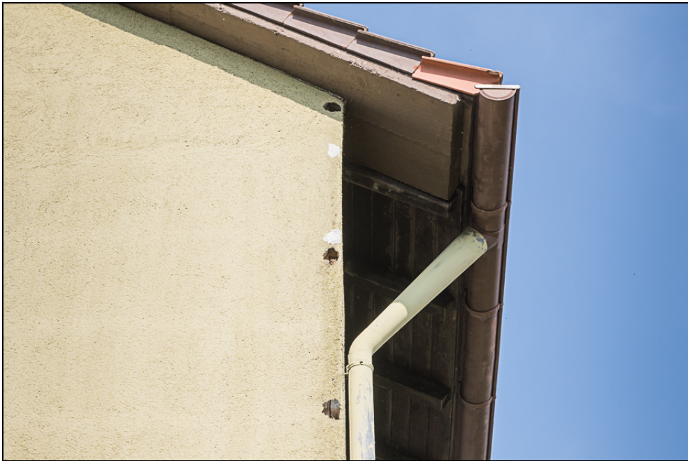
Abb. 5: Wohnhaus Nr. 135 mit Spechtlöchern in der Fassade (21.04.2021)
