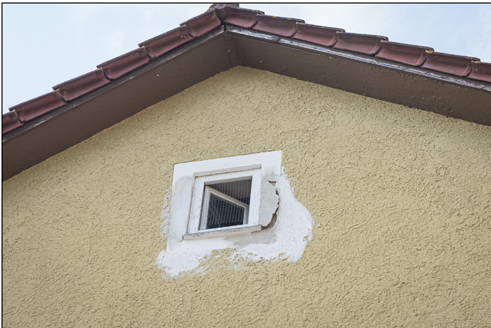
Abb. 6: Gebäude Nr. 127 mit offenem Giebelfenster und Spalt hinter der Firstscheibe
