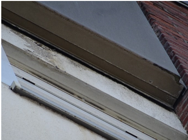
Auch die Unterkanten der Metallelemente sind dicht.
