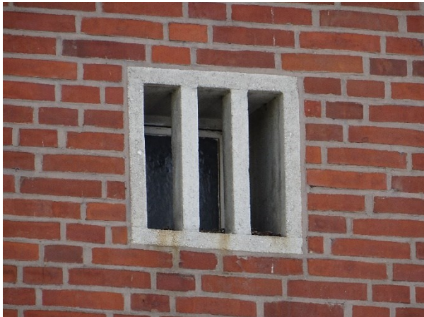
In dieser Fensternische in der Nordfassade lagen noch Reste eines Vogelneests (wahrscheinlich von Straßentauben).
