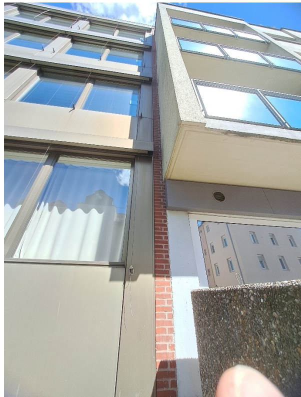
Übergang zum Haus im Süden, Westseite; kein Spalt.
