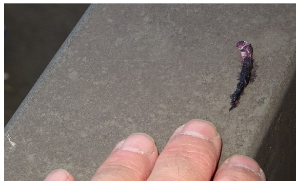
Marderkot auf der Brüstung der Dachterrasse.
