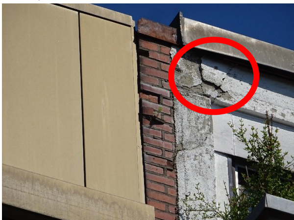
Diese potenziellen Fledermaus-Quartiere unter dem abgeplatzten Putz (Kreis) sind ausschließlich am Nachbarhaus. Die Lücken in der Backstein-Mauer links davon sind nicht groß genug; allerdings sollte man prüfen, ob die Steine dort wirklich noch festsitzen.
