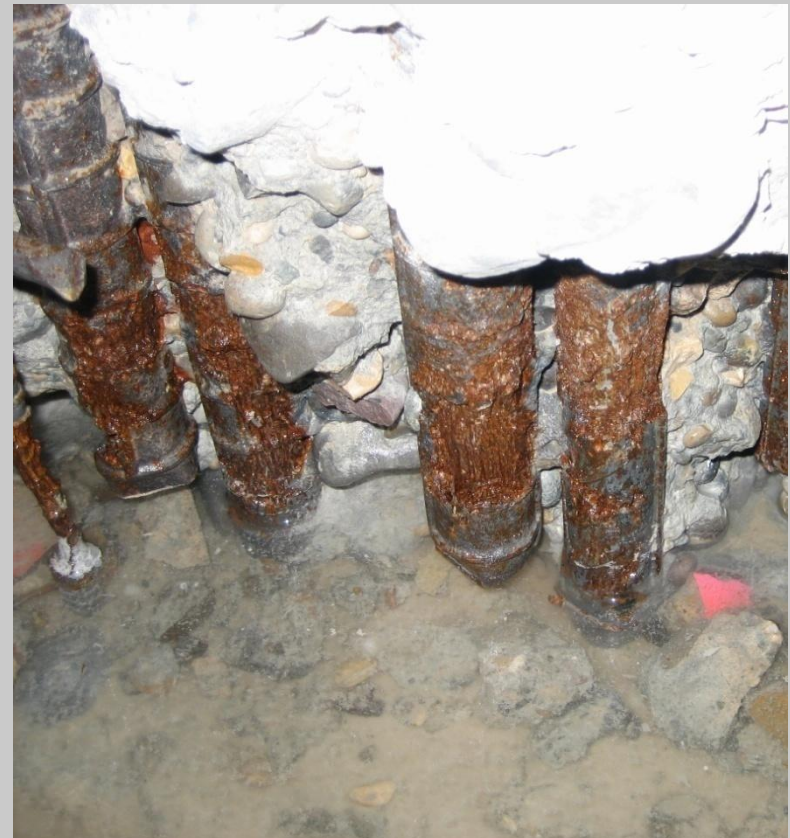
Abbildung 2: Typisches Schadensbild korrodierter Bewehrung infolge Chlorideintrages
