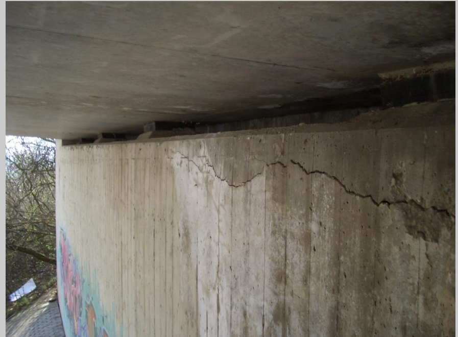
Abbildung 8: Abgeplatzte Betonschale am Widerlager FR Ulm
