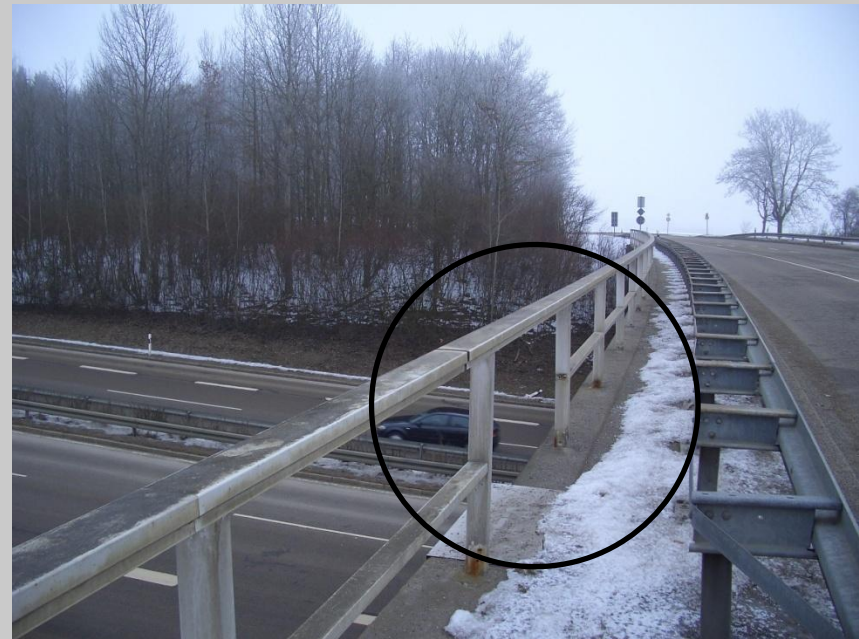
Abbildung 10: Schadhafes Geländer Brückenoberseite
