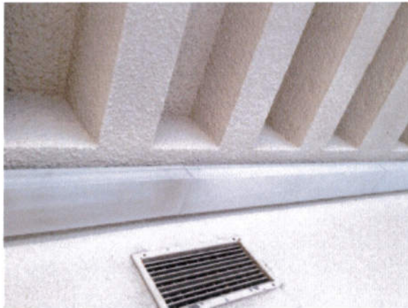
Spritzputz an der Decke
