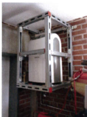
Nachgerüsteter Entfeuchter im Eingangsbereich
