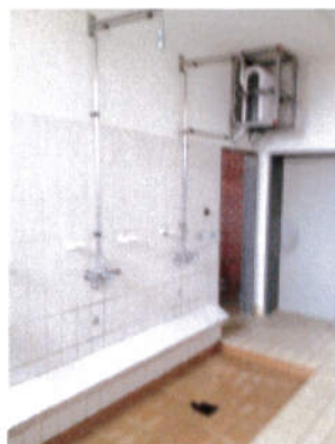
Duschbereich mit nachgerüstetem Entfeuchter
