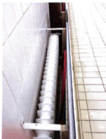
Veraltete Heizkörper hinter provisorisch festgemachten Holzplatten
