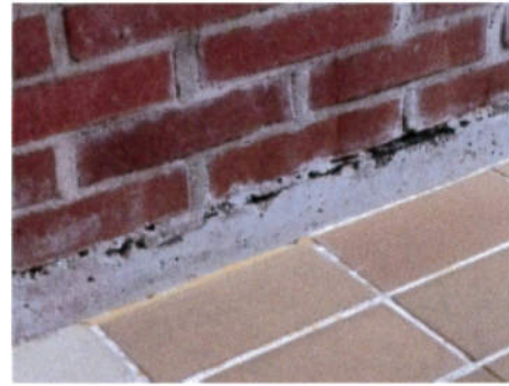
Sockenbereich der Umkleiden mit freiliegender Bewehrung
