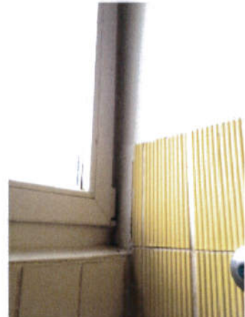
Kondensat an Wänden und Fenstern
