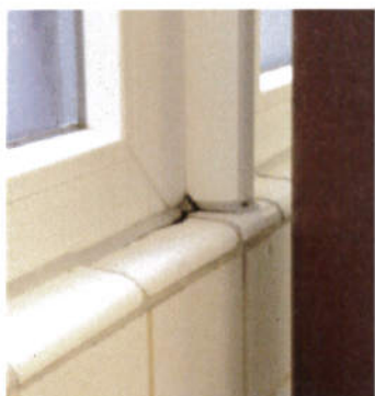
Schimmel an neuen Fenstern
