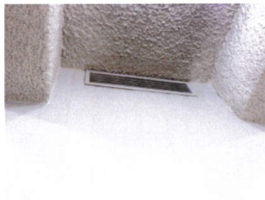
Lüftungsauslass im Deckenbereich
