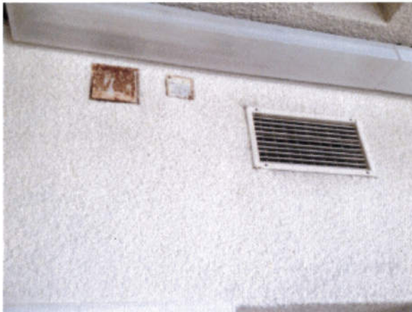
Korrodierte Metallteile an den Wänden
