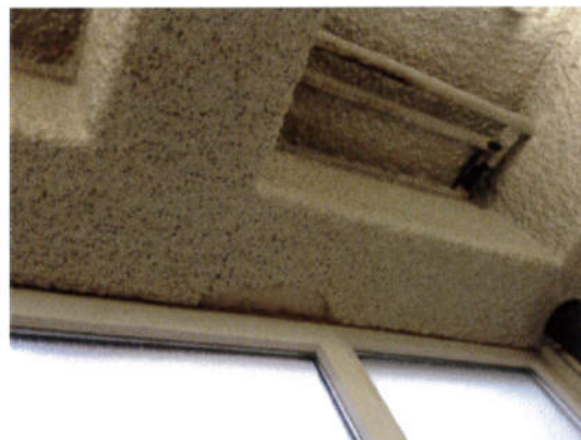
Deckenspritzputz mit Abplatzungen. Korrodierte Metallrohre (Heizungsrohre der darüber liegenden Sporthalle)
