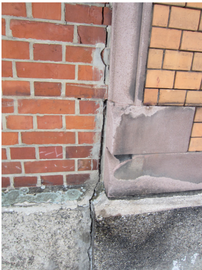
Bild 18: Riss an der Südfassade Haus Klingensteiner Straße 57
