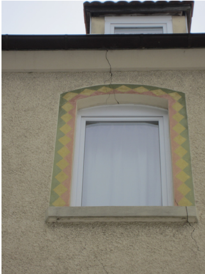
Bild 13: Risse an der Nordostfassade Haus Meinlohstraße 19
