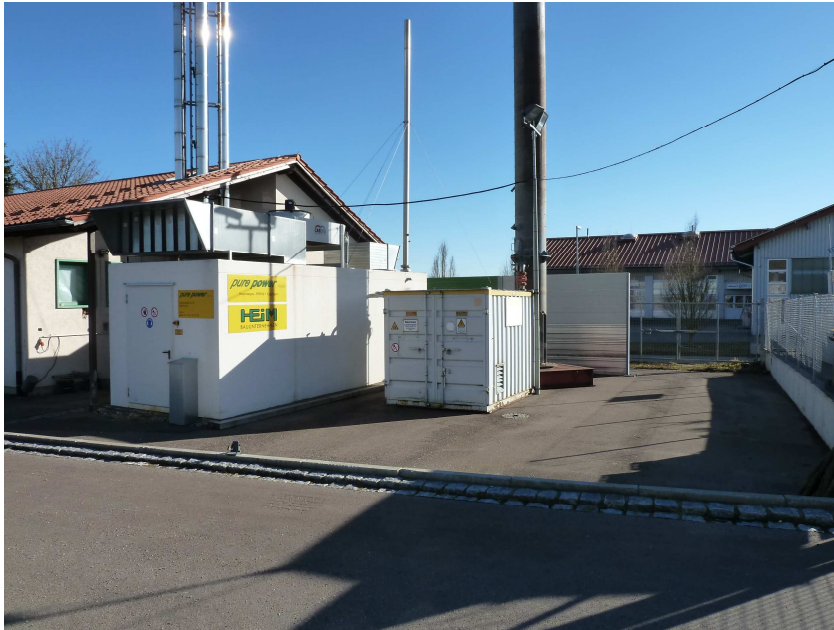
Blockheizkraftwerk und Deponiegasfackel Deponie Eggingen
