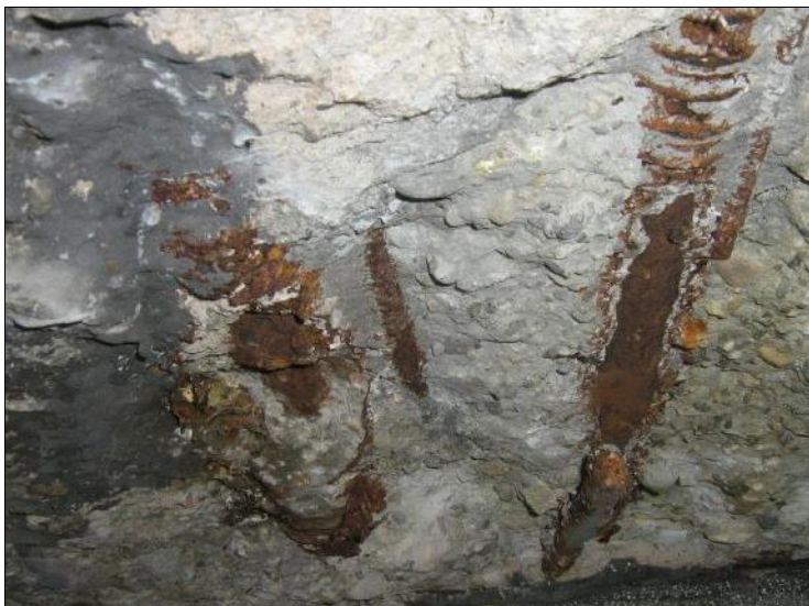
Freiliegende korrodierte Spannglieder
