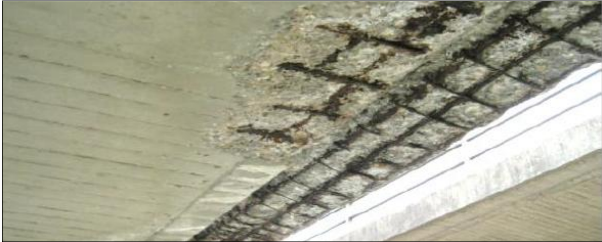
Abplatzungen durch Korrosion der Bewehrung
