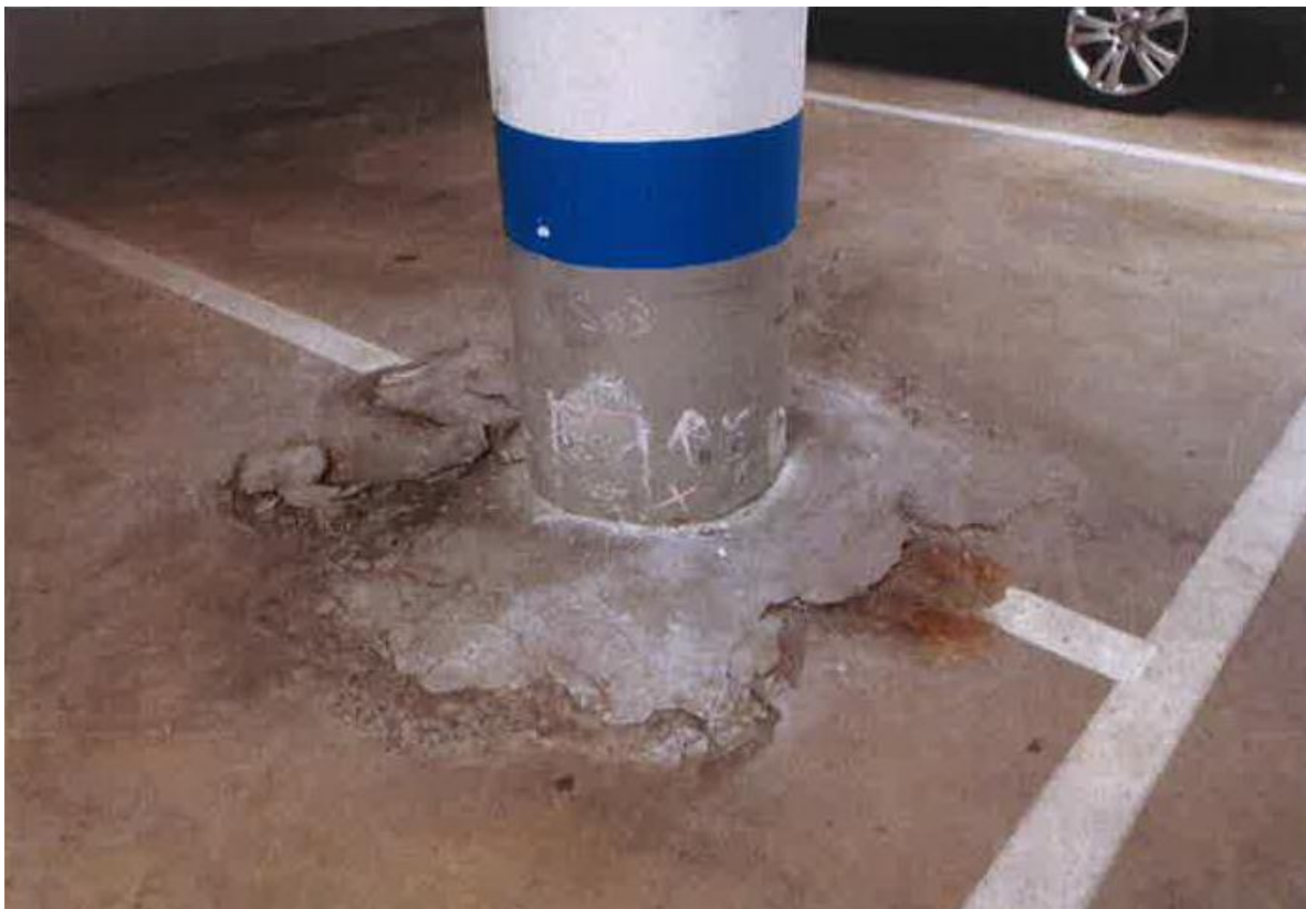
Großflächige Abplatzungen in reprofilierten Bereichen der Stützenfüße mit Hohllagen und korrosiven Verfärbungen
