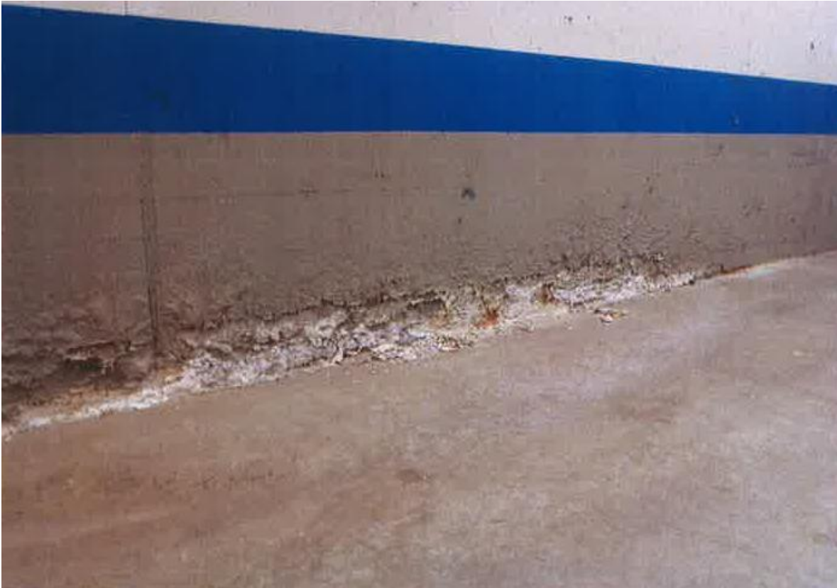
Ablösung der Beschichtung im Fußbereich der Wände und Stützen mit korrosiven Verfärbungen.
