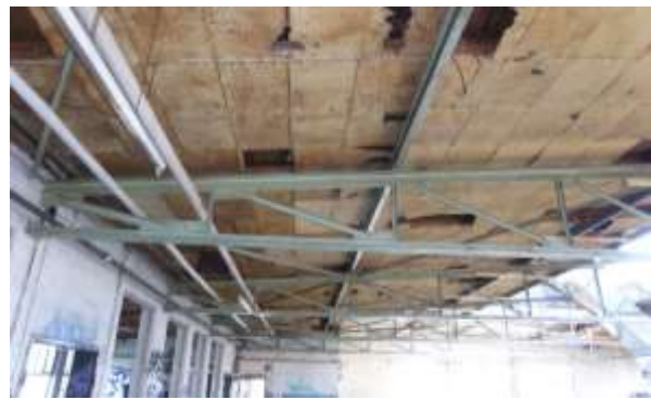
Decke der mittleren Halle innen mit Styropor verkleidet
