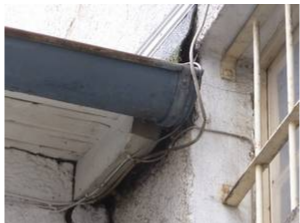
Übergang zwischen Hallen und dreistöckigem „Mittelbau“ mit Lücke bzw. Spalte.
