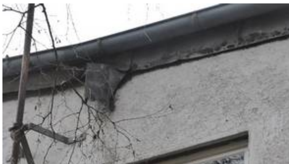
Schäden in Dachverkleidung der Westseite des „Mittelbaus“, dadurch entstehen Lücken und Spalten.
