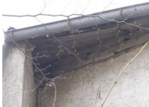
Lücken und Spalten in der südwestlichen Dach-Ecke des „Mittelbaus“.
