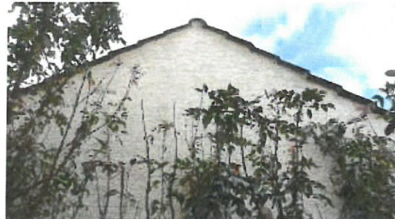
Ostgiebel dieser Garage: Hermetisch dicht, weder Lücken noch Spalten, minimaler Dachüberstand.
