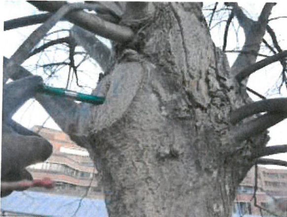
Eine der beiden „Löcher“ in Baum Nr. 17. Der Kugelschreiber steckt „auf Anschlag“.
