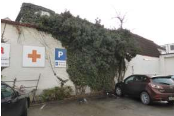
Nordwestecke von Gebäude 11 mit voluminösem Efeu.
