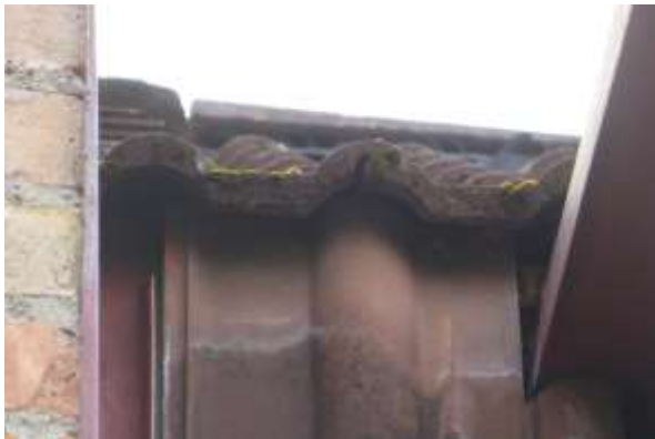
Detail: Hier sind deutlich größere Lücken erkennbar.
