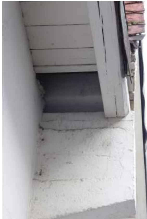
Dto., Lücken im Dachüberstand.
