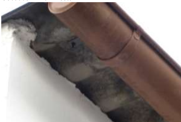
Dto. Dachüberstand mit Lücken, aktuell ohne Besiedlungsspuren.
