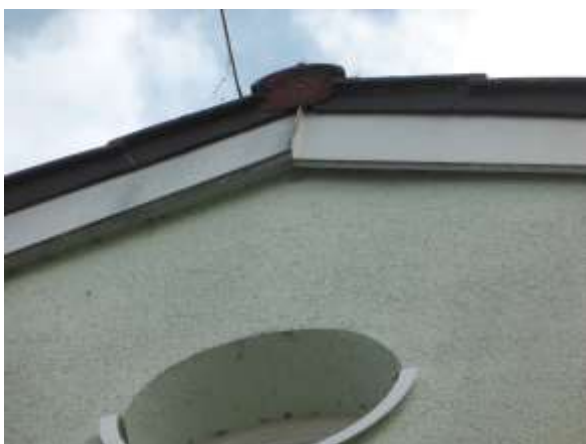
Windbretter im Nordgiebel des westlichen Trakts; die vermeintliche Lücke rechts ist nach wenigen cm ausgefüllt und dicht.
