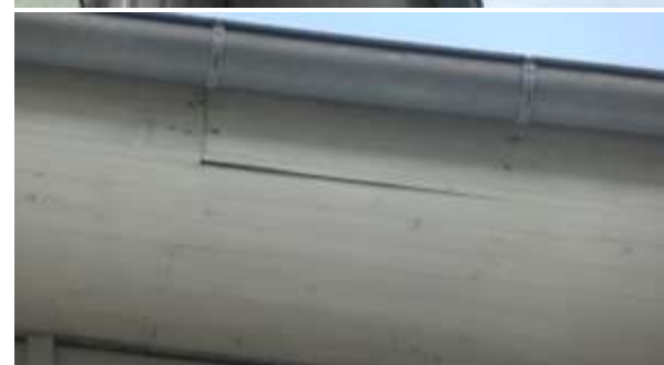
Zwei Lücken in Holzverschalung des Dachüberstands auf Westseite.
