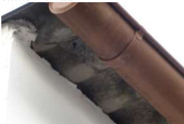
Dto. Dachüberstand mit Lücken, aktuell ohne Besiedlungsspuren.
