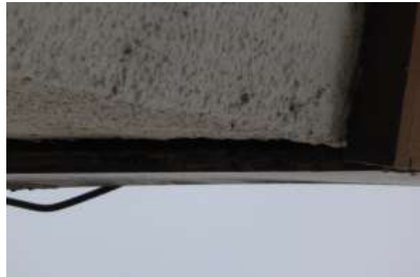
Verblechung an Dachkante dicht anliegend.
