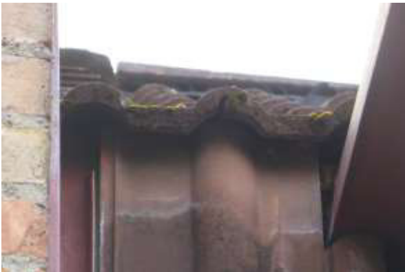
Detail: Hier sind deutlich größere Lücken erkennbar.
