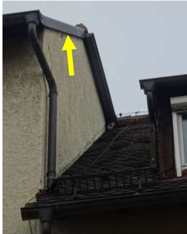
Vorderseite, Westrand (rechts), Dachüberstand von Hausnr. 24 (links) wieder mit Spalte (Pfeil).
