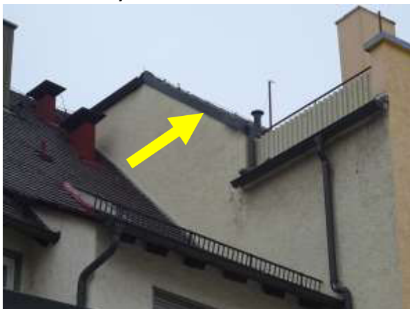
Giebel von Haus Nr. 24, Überstand (Pfeil) mit Spalten.
