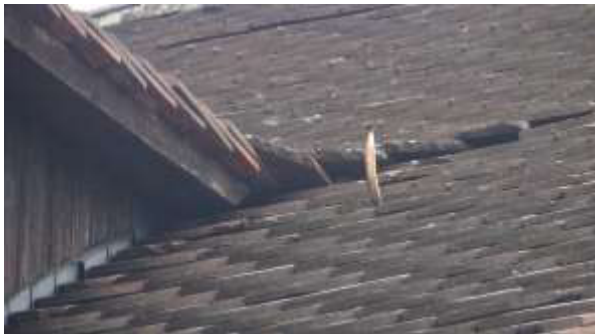
An der Oberkante der Gauben klaffen Lücken zwischen den Dachplatten.
