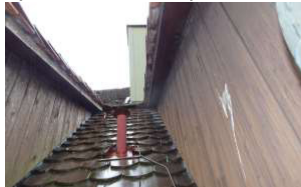
Blick zwischen die Gauben, über dem Lüftungsrohr sind die leicht aufstehenden Ziegel erkennbar.
