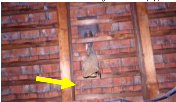
Mit Papier verstopfter Lüftungziegel.
