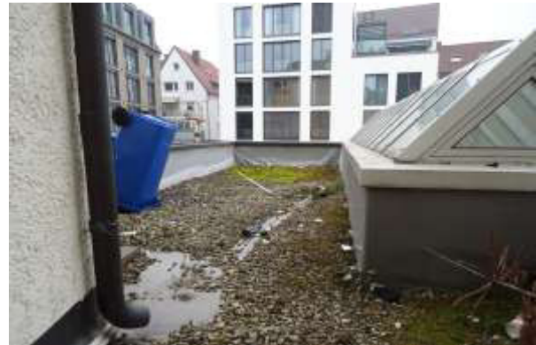
Flachdach über der Einzelgarage, rechts Überdachung des Eingangsbereichs. An Mauern ist Folie hochgezogen, Spalt der Blechabdeckungen deshalb innen glatt.
