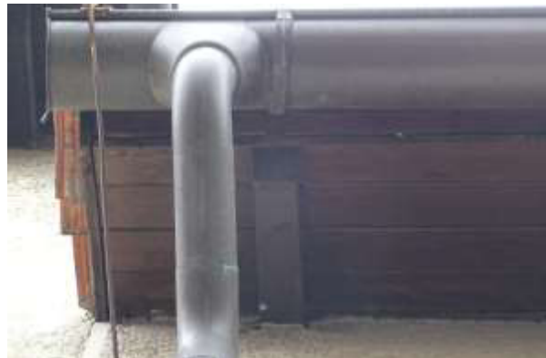
Südwestecke Dach, Fuge an Kante zu klein für Fledermäuse bzw. dahinter befindet sich kein Hohlraum.
