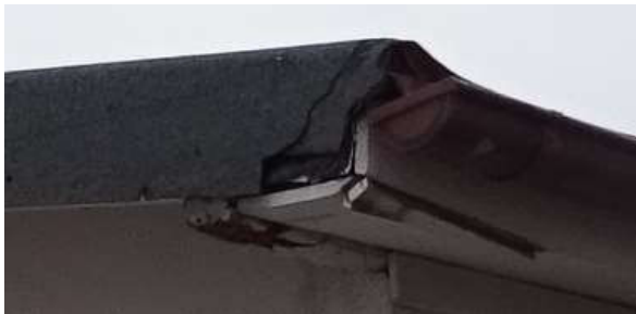
Lücke am südöstlichen Dachüberstands-Eck, potenzielle Einflugmöglichkeit für Fledermäuse oder Nistplatz z. B. für Spatzen, aber auch mit Endoskop keine Hinweise bzw. Nachweise.
