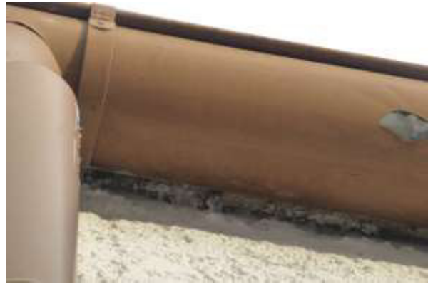
Dto., Dachrinne liegt fugenlos an Hauswand an.
