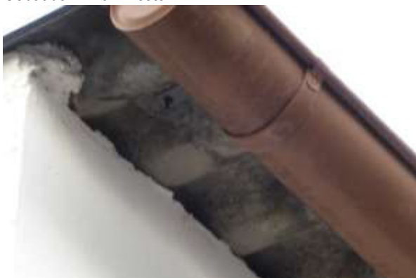
Dto. Dachüberstand mit Lücken, aktuell ohne Besiedlungsspuren.
