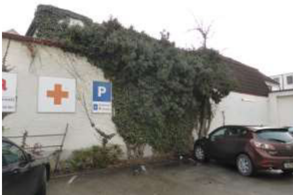
Nordwestecke von Gebäude 11 mit voluminösem Efeu.
