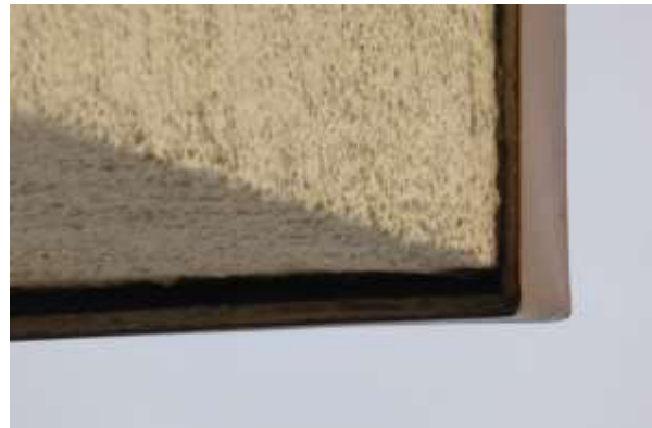
Dachüberstand mit Spalte, aber abgedichtet.
