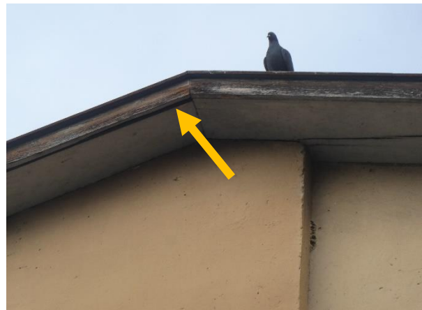
... hier einmal das abstehende Brett mit Spalte, in die vermutlich Fledermäuse einfliegen; zum Anderen ein potenzieller Dachbodenbewohner, wenn man nur ein Fenster öffnen würde ...
