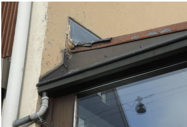
Anschluss Überdach Gaststätte; reines Blech, keine Haltemöglichkeiten für Vögel oder Fledermäuse.
