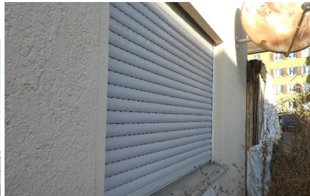
Rollladenkästen innen glatt, Rollläden waren bis vor Kurzem außerdem noch im Betrieb.
