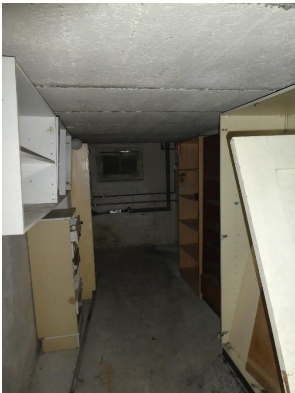
„Mini“-Keller nur unter dem Hausflur, ohne Öffnungen (Fenster im Hintergrund war geschlossen)..
