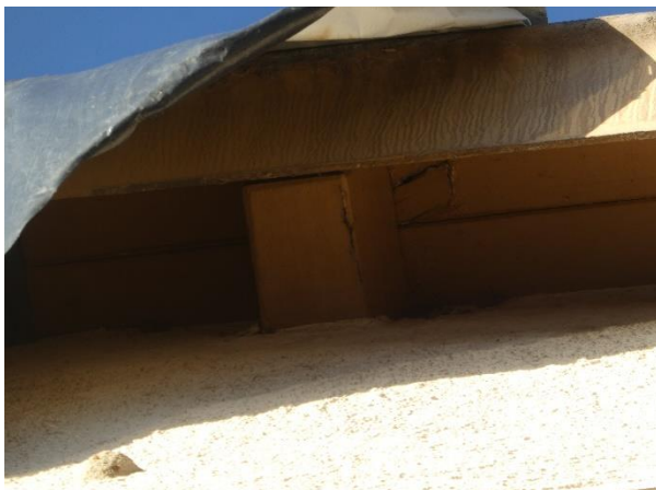
Der hier offene Dachüberstand war vor Kurzem noch zugebaut.
