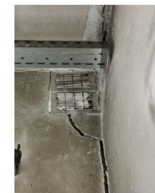
Abb. 8: Riss in der Außenfassade, durchgängig in den Innenbereich. Die Öffnung im Bild ist von Innen vergittert.
