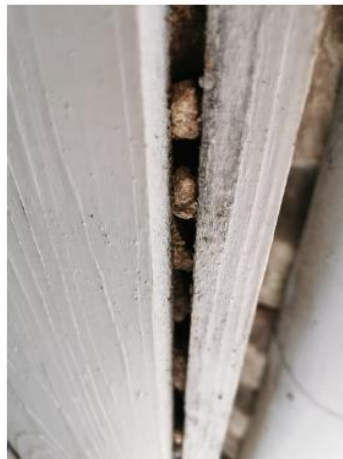
Abb. 4: Vermutlich Nistmaterial im Dachüberhang der Dachgaube.
