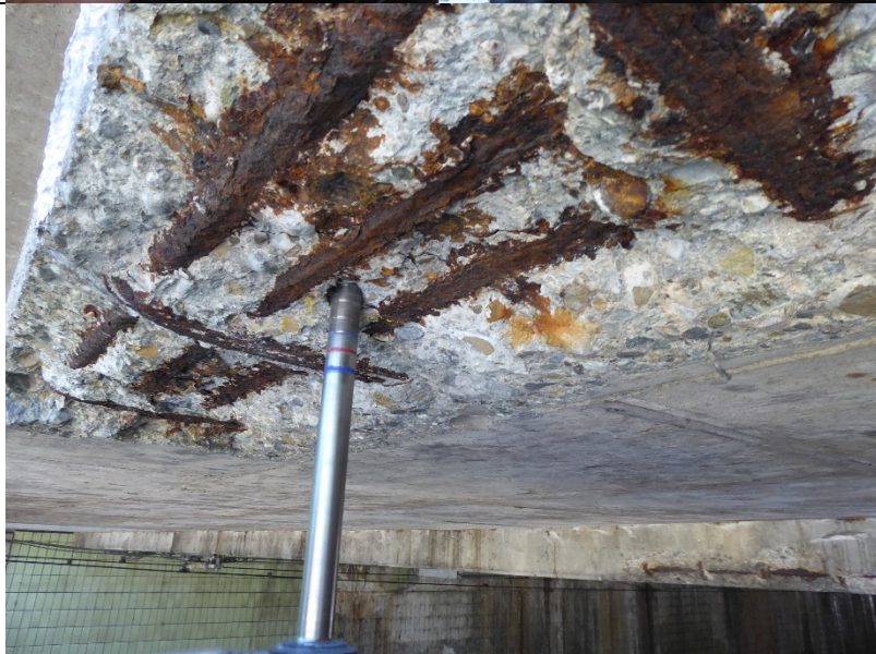
Bild 3: Querschnittsverlust an der Schadstelle
