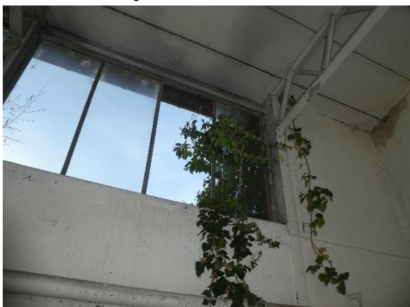
Auf der Südwestseite fehlt eine ganze Scheibe.
