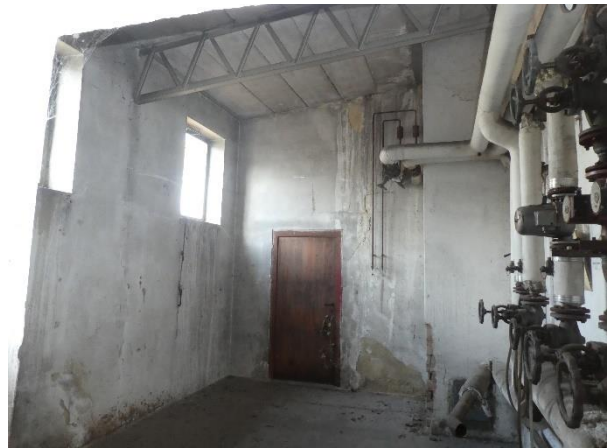
Raum an der Südseite mit Strom- und Wasserverteilung sowie mit verschlossener (und schon lange nicht mehr genutzter) Tür nach außen zur Kleinen Blau.
