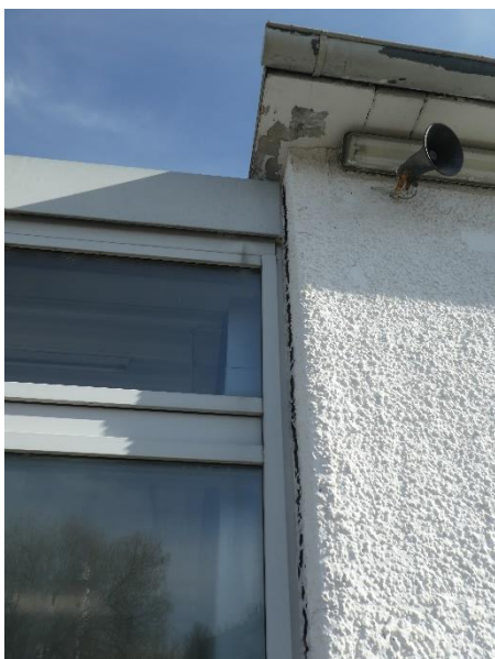
Dto.; der senkrechte Riss ist erst durch die benachbarte Bebauung entstanden
