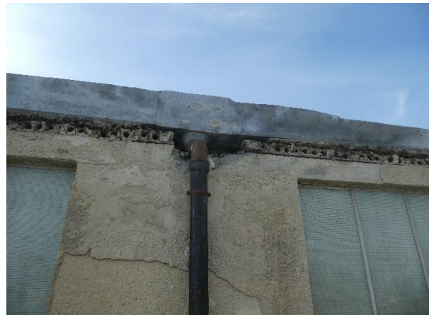
Durch den Abbruch der Gebäude nördlich entstandene offene Fassadenteile.
