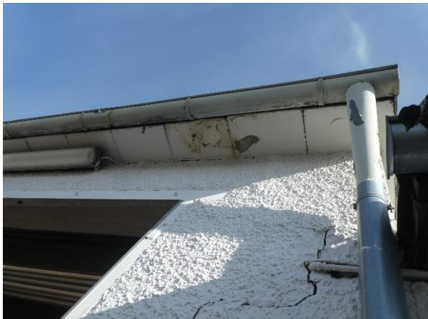
Dachüberstände an den Gebäuden Innere Wallstr. 38+40, mit Spalten, Hohlräume dahinter potenzielle Fledermausquartiere.
