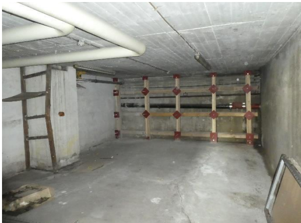
Kleiner Keller unter den Büros; Rückwand wurde durch Abbruch/Bebauung nördlich etwas in Mitleidenschaft gezogen und musste versträkt werden.
