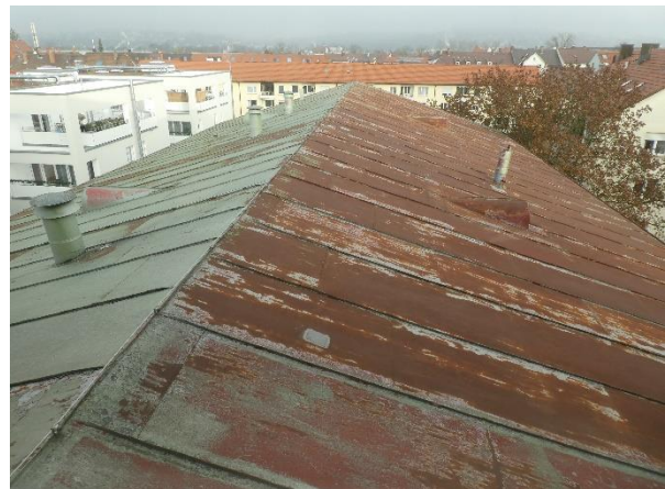
Blick über das Blechdach des Nordteils. Dieselbe Konstruktion hat auch das Dach im Südteil.
