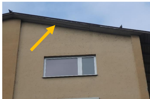
Östlich benachbart eine weitere Spalte im Dachüberstand.
