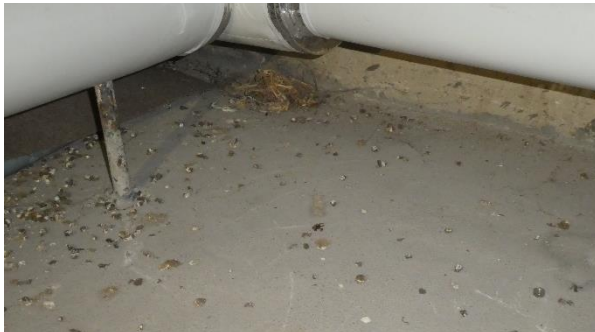
Andere Dachecke mit Taubenkot, im Hintergrund Tauben-Skelettreste.
