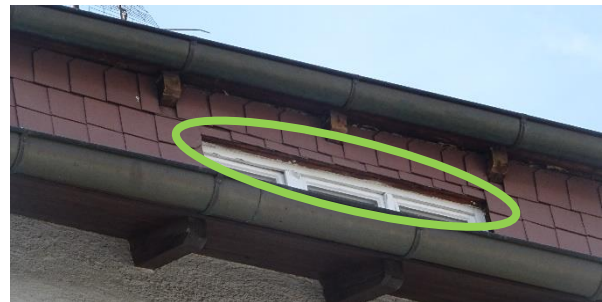
... Mittelteil (die Spalten über den Fenstern waren dicht, deshalb grün markiert) und ...
