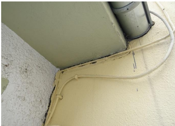
Auf der Ostseite sind die Garagen an das nächste Haus in der Gneisenaustraße angebaut; der Riss in der Mauer ist nur wenige mm breit.
