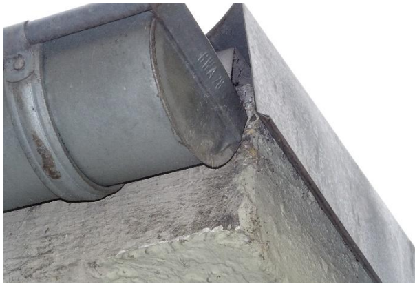
Zwischenraum zwischen Dachblech und Mauer zu eng.
