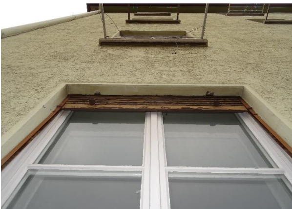
Im Erdgeschoß gibt es Jalousien, der Spalt zwischen Lamellen und Mauer ist aber nur wenige mm breit.
