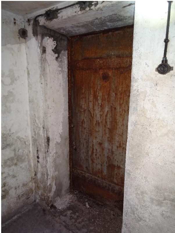
Der südliche Zugang ist versperrt.
