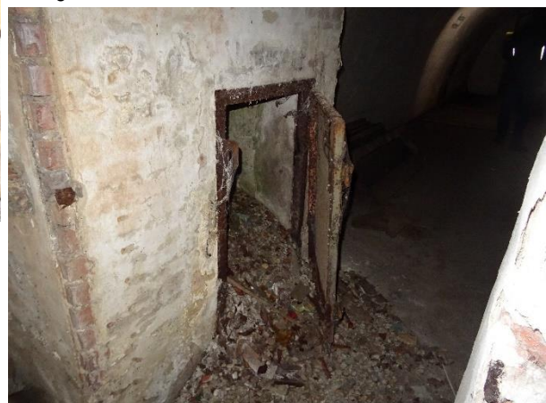
Untere Öffnung des Lüftungsschachts, der mittig im Hof mündet und dort durch ein Gitter abgedeckt ist.
