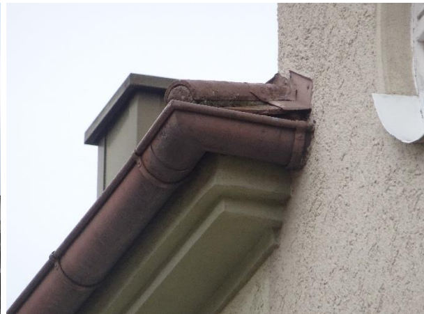
Einzigste Lücke im Dachüberstand an den Treppenhaus-Gaube oberhalb der Dachrinne; zu klein für Vögel bzw. zu offen für Fledermäuse.
