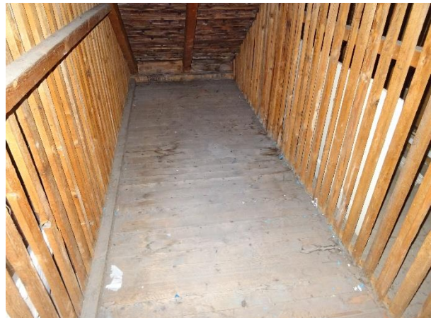
Mäusekot in ausgeräumtem Abteil.
