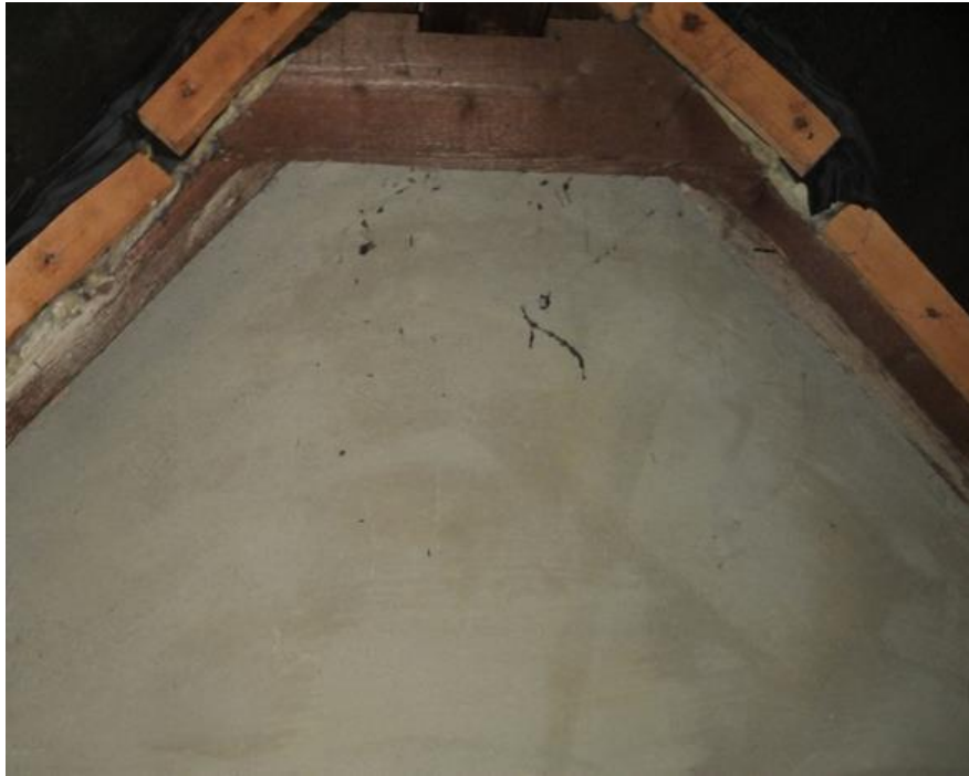
Abb. 3: Fledermauskotnachweise im Dachboden
